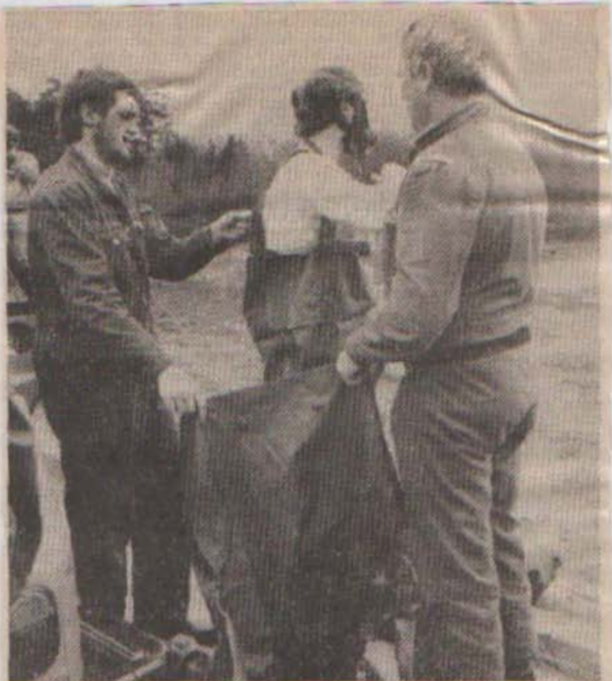
Punkt 19 Uhr gestern abend befanden sich drei Männer des ABC-Zuges an ihrer Einsatzstelle. Ein letztes Mal wurde die Dichtigkeit der Anzüge überprüft, dann trug man vorsichtig den letzten Meter ab, unter dem sich die vermeintlichen Fässer befinden sollten.
